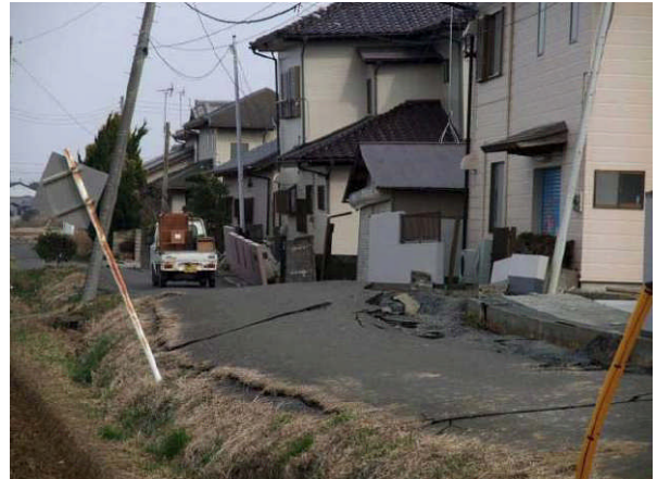
千葉県旭市野中の砂鉄採取跡地の埋め立て造成地では、道路が大きく波打ち戸建て住宅が大きく傾いた。 盛土が低い水田に向かって側方流動し、電柱や標識も別個に傾いている
