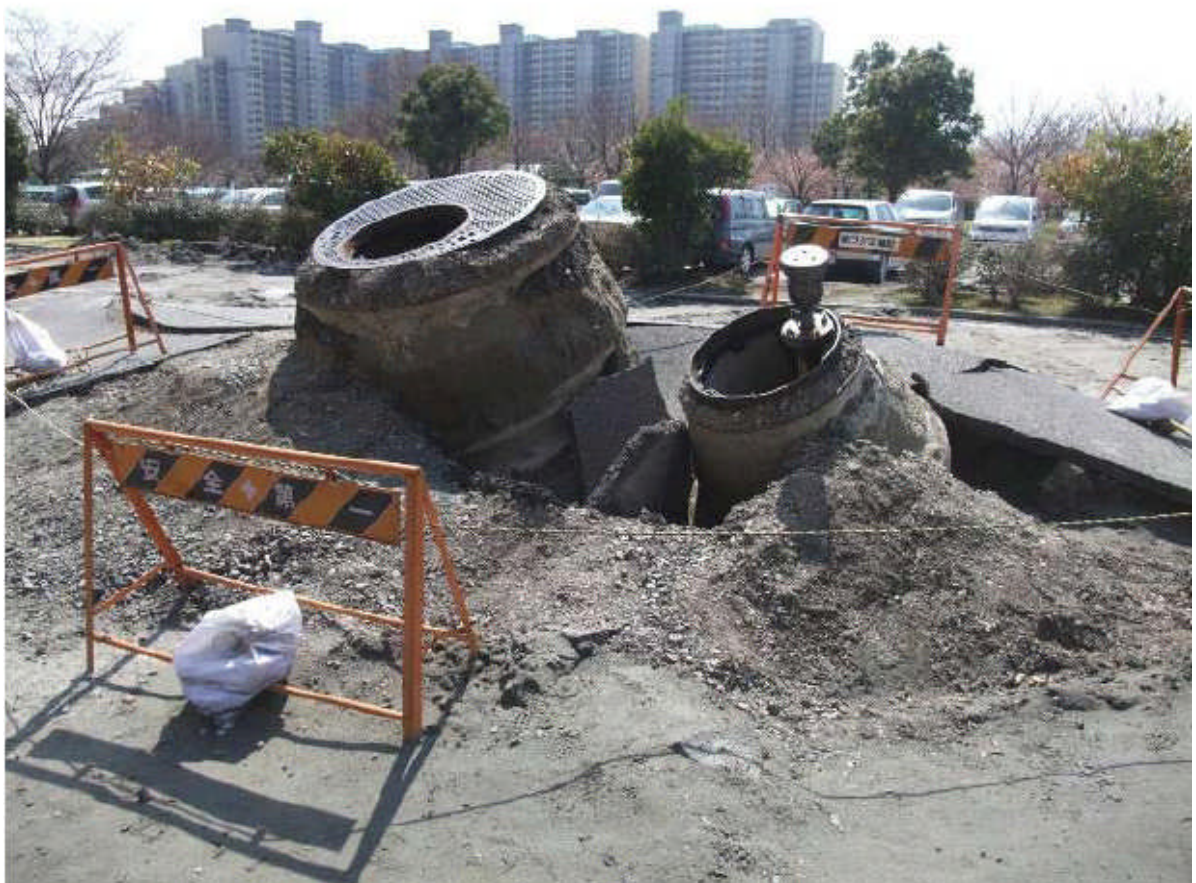
千葉県浦安市高洲では埋立地が広く分布し、ライフライン等大きな被害を受けた。写真は地下埋設物が浮き上がった例。耐震貯水槽が浮上し、使用不能となった。
