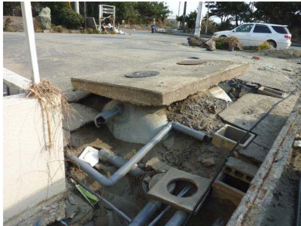
千葉県旭市三川東部の浄化槽浮き上がり近接写真 現地では、40～50cm の浮き上がりが確認された。 液状化は津波が襲来する以前に発生した。
