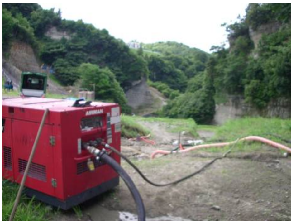
写真—2 コンプレサーとエアーリフト井
